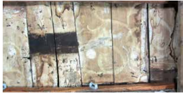
Abb. 16: Die gotischen Bohlenteile sind wahrscheinlich 1793 während der Abriss- und Umbauarbeiten am „Neuen Münzhaus“ von 1465 als „Einschubdecke“ hier zweitverwendet eingebaut worden. Auf den Unterseiten zeichnet sich eine Rankenmalerei ab.
