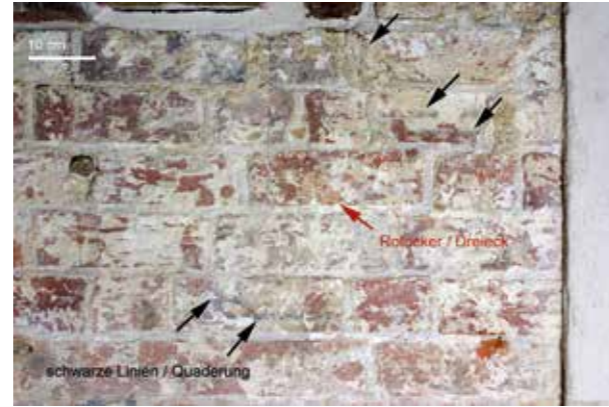
Abb. 9: Fragmente eines Gestaltungsbefundes des 15. Jahrhunderts(?) auf der Nordwand: eine rot-weiße Quadermalerei mit schwarzen doppelt gezogenen Konturstrichen.
