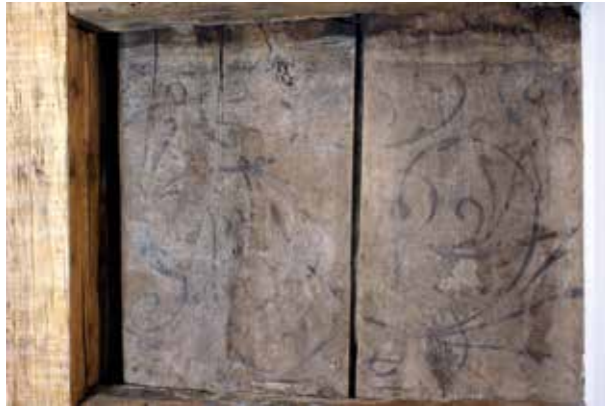
Abb. 8: Ein heute sichtbares Befundfeld mit schwarzen Fadenranken von 1304 nach der Konservierung.
